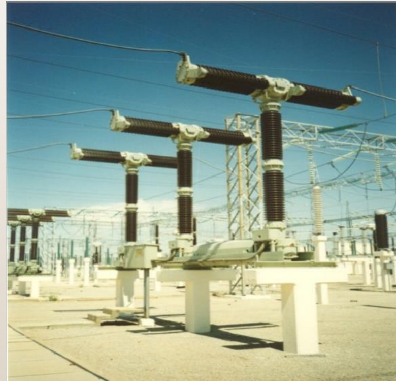
Interruptor de Potencia de 245KV
